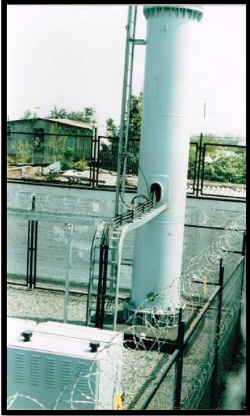
2da antena instalada en el 1er sector de Lo Hermida, cerca de Avda Grecia con Tobalaba.
