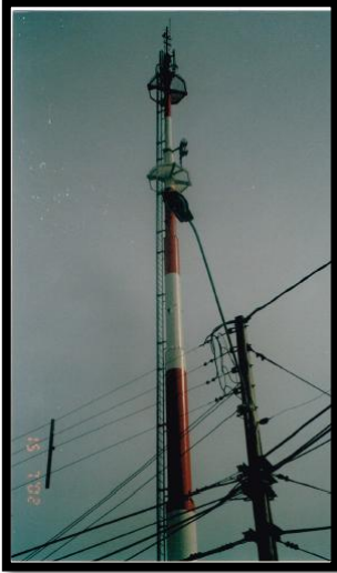
2da antena instalada en el 1er sector de Lo Hermida, cerca de Avda Grecia con Tobalaba.
