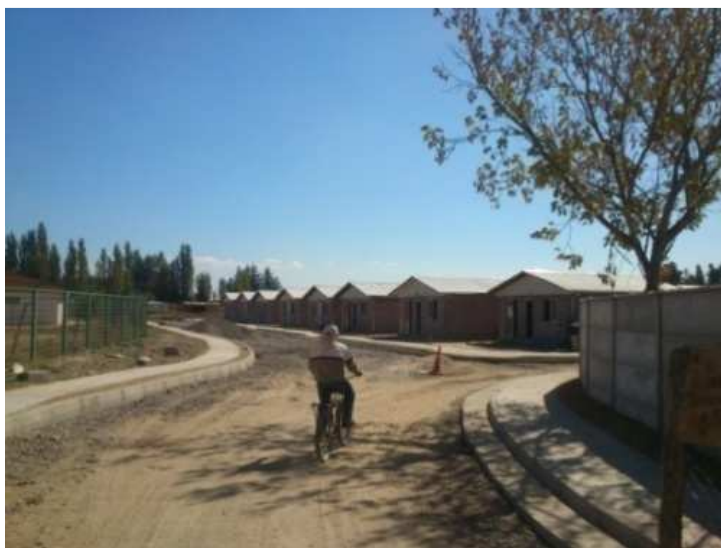
Figura N° 9 Trabajador entrando a la obra actualmente en construcción “Villa Pablo Neruda y Las Rosas”
