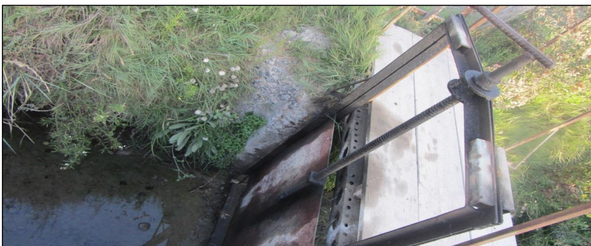
Imagen N°28. Compuertas canal La Cachina. Huasco Bajo.
