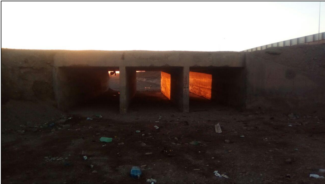
Fotografía 18: Ducto construido para el control del caudal
