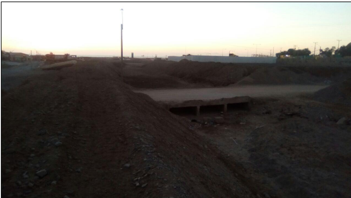
Fotografía 19: Ducto construido para el control del caudal
