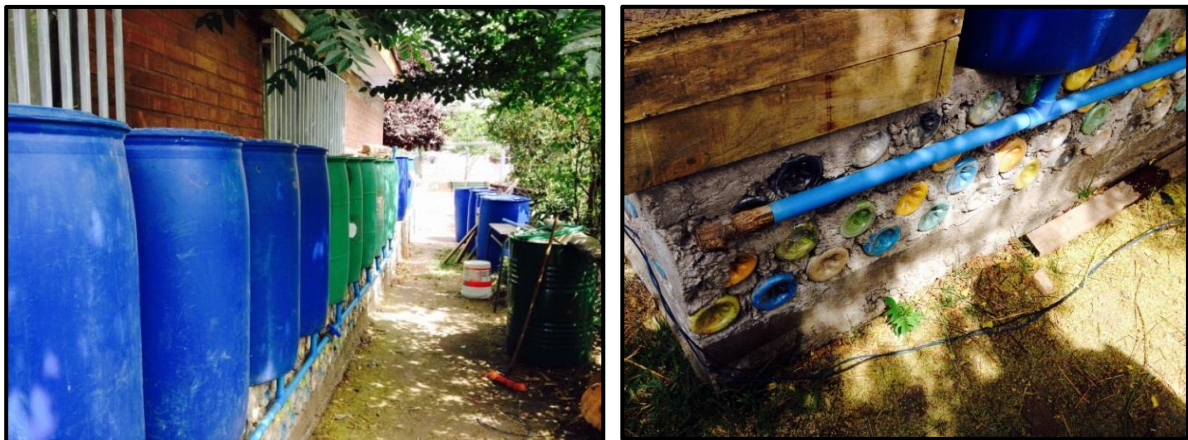
Figura 11: sistema de recolección de aguas lluvias. Fuente: archivo personal
