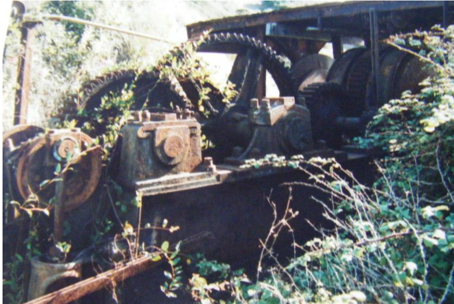
Figura 14: Fotografía que muestra en detalle las características de los winches de la planta, ya oxidados y sumidos en el abandono, en el año 1996. (Colección privada de Carlos Macaya).
