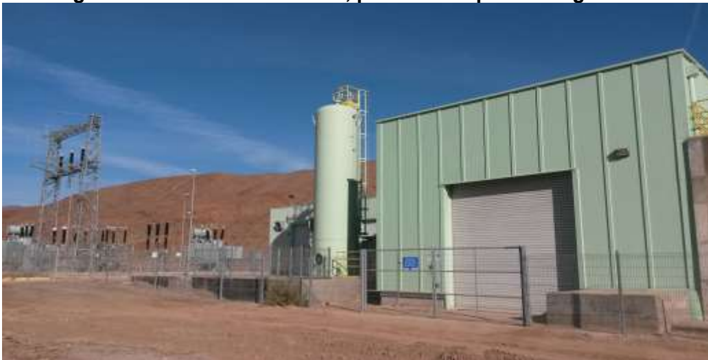
Imagen 13: Estación de bombeo, para el transporte de agua de mar
