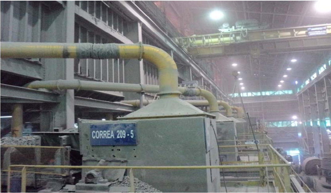
Fig. 26: Campana en Chutes de traspaso.
