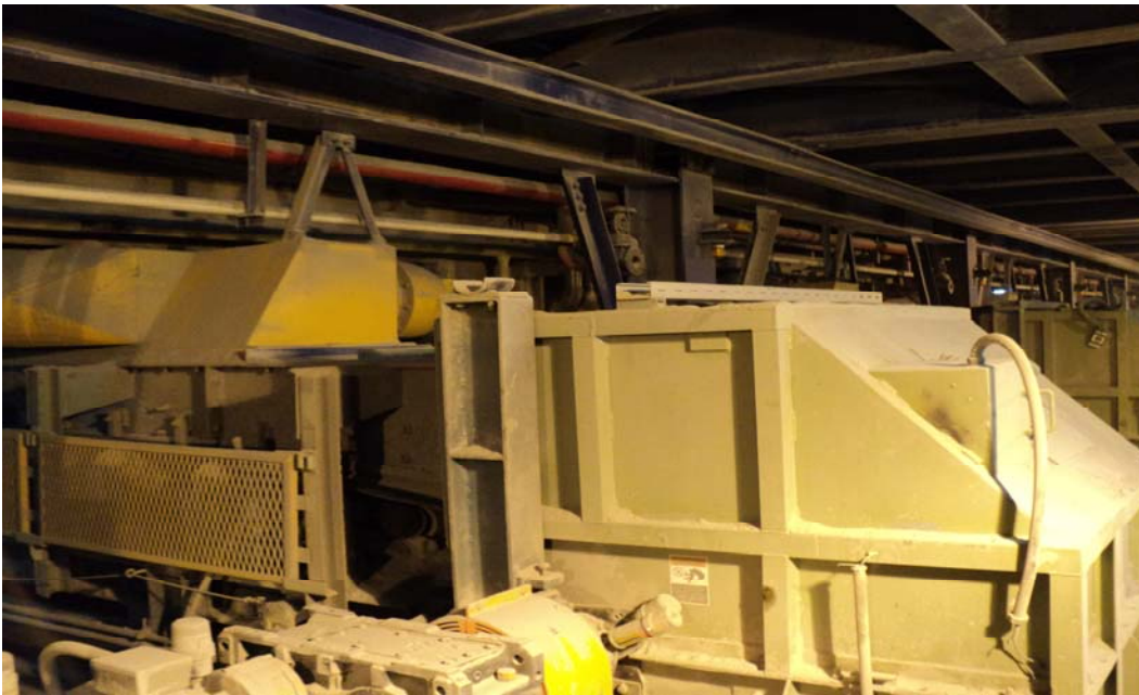
Fig. 24: Campana en una tolva de carga.
