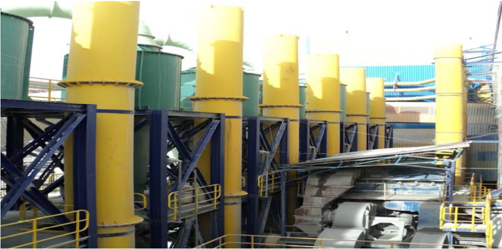
Fig. 15: Área Colectores de Polvo Chancadores.
