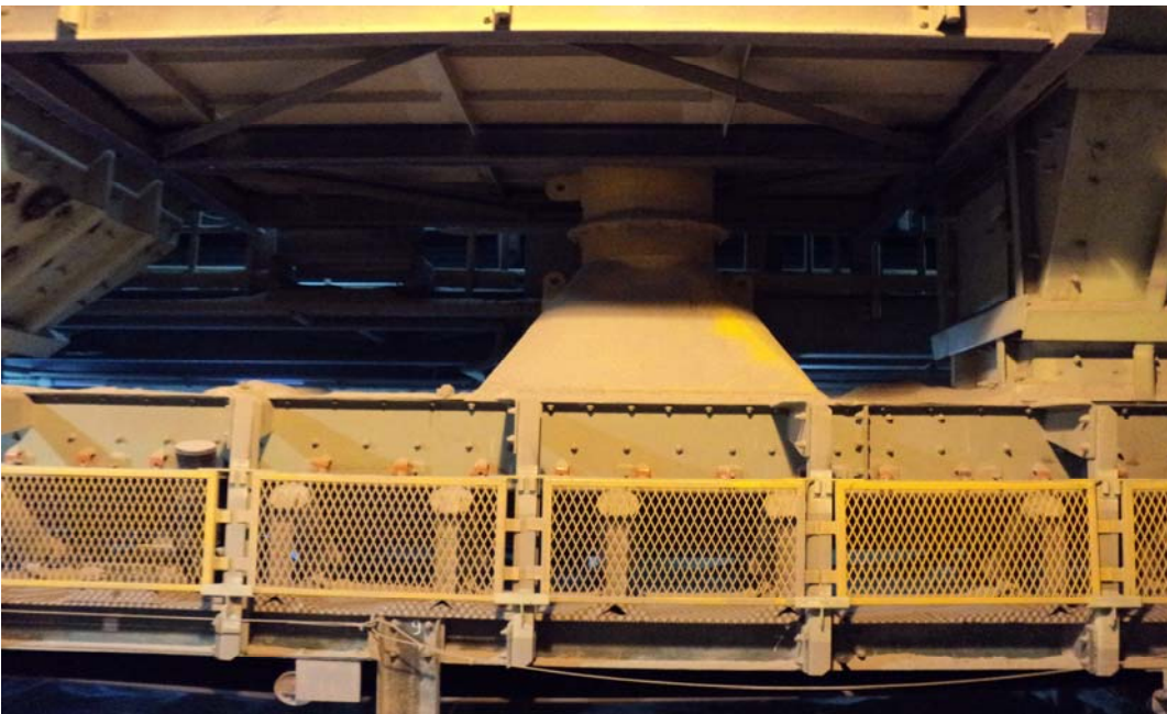
Fig. 25: Campana en una Correa transportadora.
