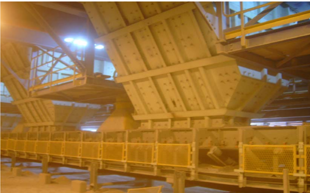
Fig. 49: Chute de Carga Correa 110.
