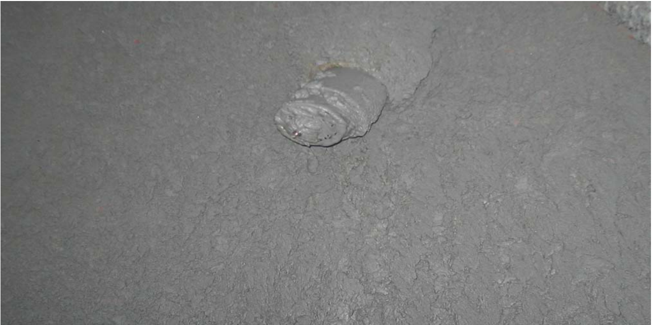
Fig. 42: Boquilla hidroneumática en el interior del Chute de descarga.
