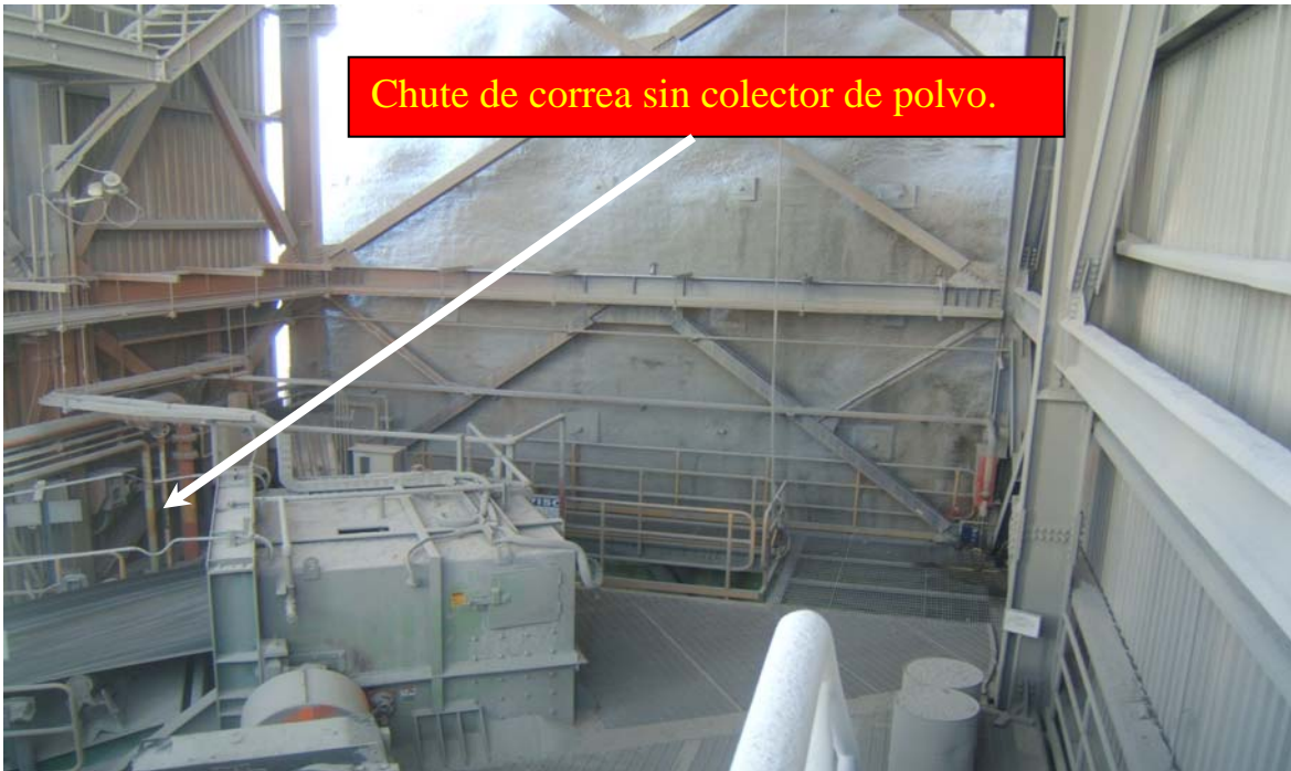
Fig. 56. Chute de correa 102, sin sistema colector de polvo.
